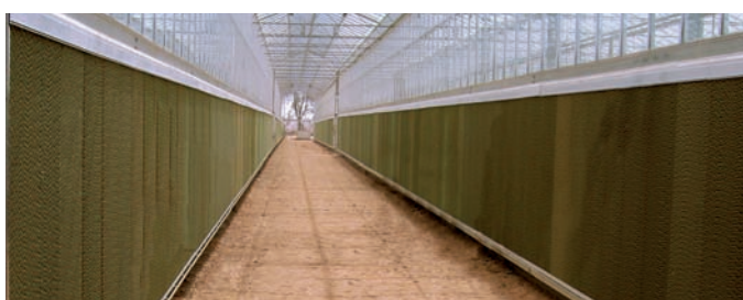
■ Pad & Fan cooling system
